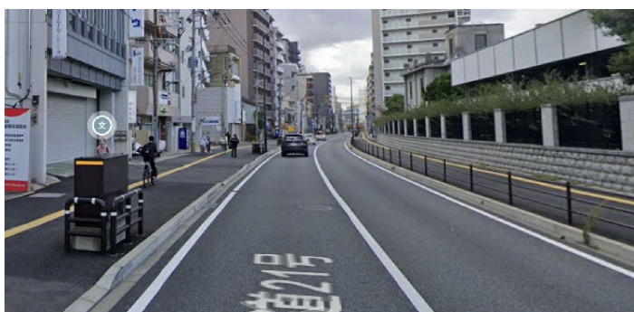
馬出九大病院前の無電柱化地上機器
